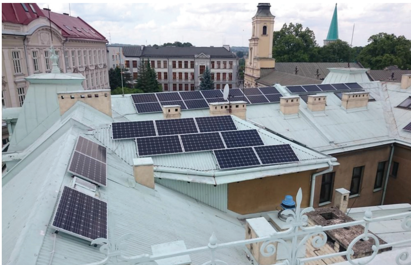
Zainstalowanie 932. paneli fotowoltaicznych o mocy 252 kWp na 6 obiektach powiatowych pozwoliło na znaczne obniżenie kosztów energii elektrycznej – tu na przykładzie DPS Pogodna Jesień w Cieszynie.
